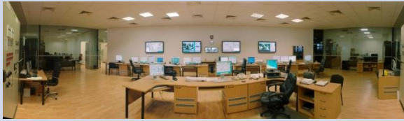
Blokinis valdymo pultas po modernizavimo
